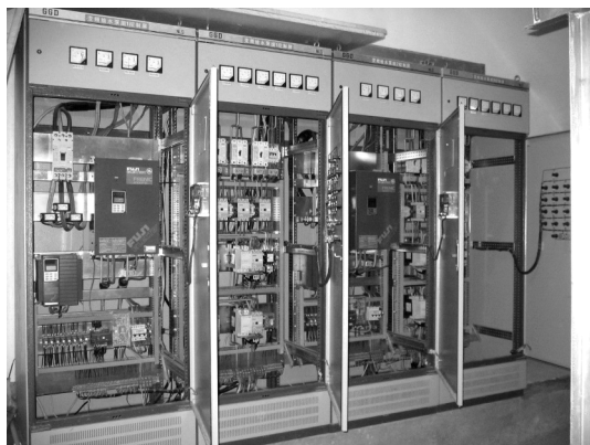
图 1-2 继电器系统电气柜
