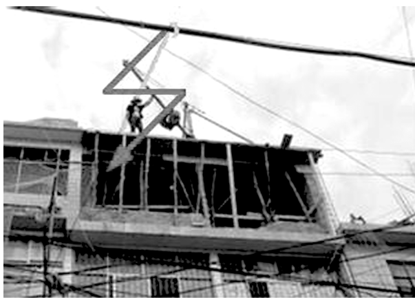
图 2-5 陈某触电事故模拟现场
